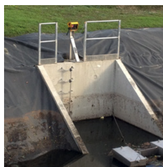
▷ Apertura de una compuerta de purga.
