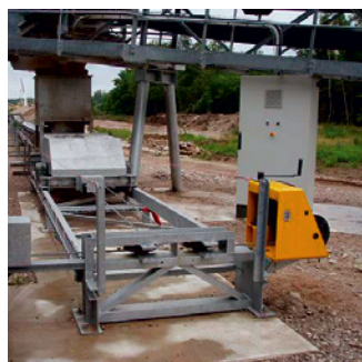
▷ Tensado de la cinta transportadora.
