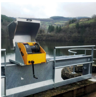
▷ Apertura de una compuerta de purga.
