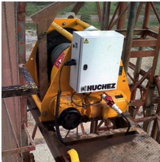
▷ Elevación de carga en una fábrica de cemento.
