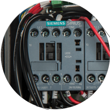
Sistema operativo SIEMENS / SIEMENS relays
